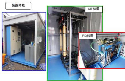
エネルギー回収システム全景
